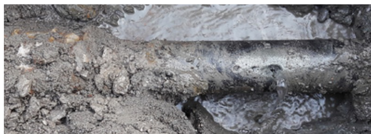
Lochfrass bei Duktulgussleitung NW 125 (Neufeldstrasse Eichenwies) mit Jahrgang 1971
