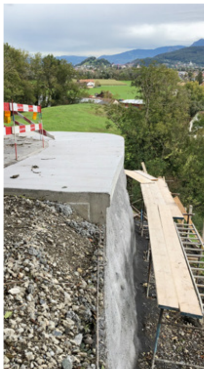
Armierter Betonplatte als Abdeckung der bewehrten Spritzbetonwand sowie als Abschluss zum «Schwarzbelag» der Bergstrasse
